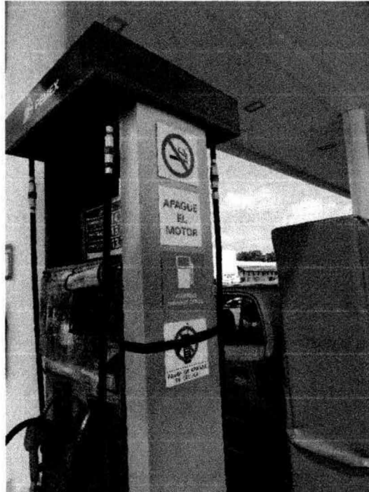
5.-Otra vista de los dispensarios donde se observa los letreros de prohibido fumar, prohibido usar el celular y el letrero de apagar el motor.
