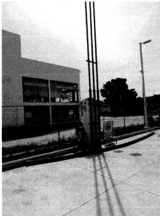
8.-Los tubos de venteo están aterrizados a tierra física, el extintor tipo carretilla con señalización adecuada y la lámpara contra explosiones.
