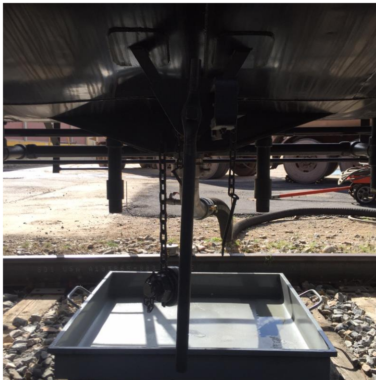
Fig. 11. Charolas para contención de derrames de materiales peligrosos
