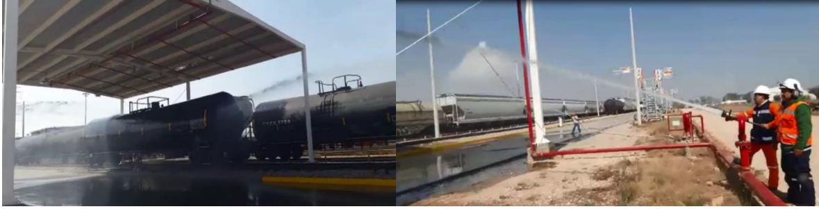
Fig. 10. Pruebas del equipo contra-incendio
