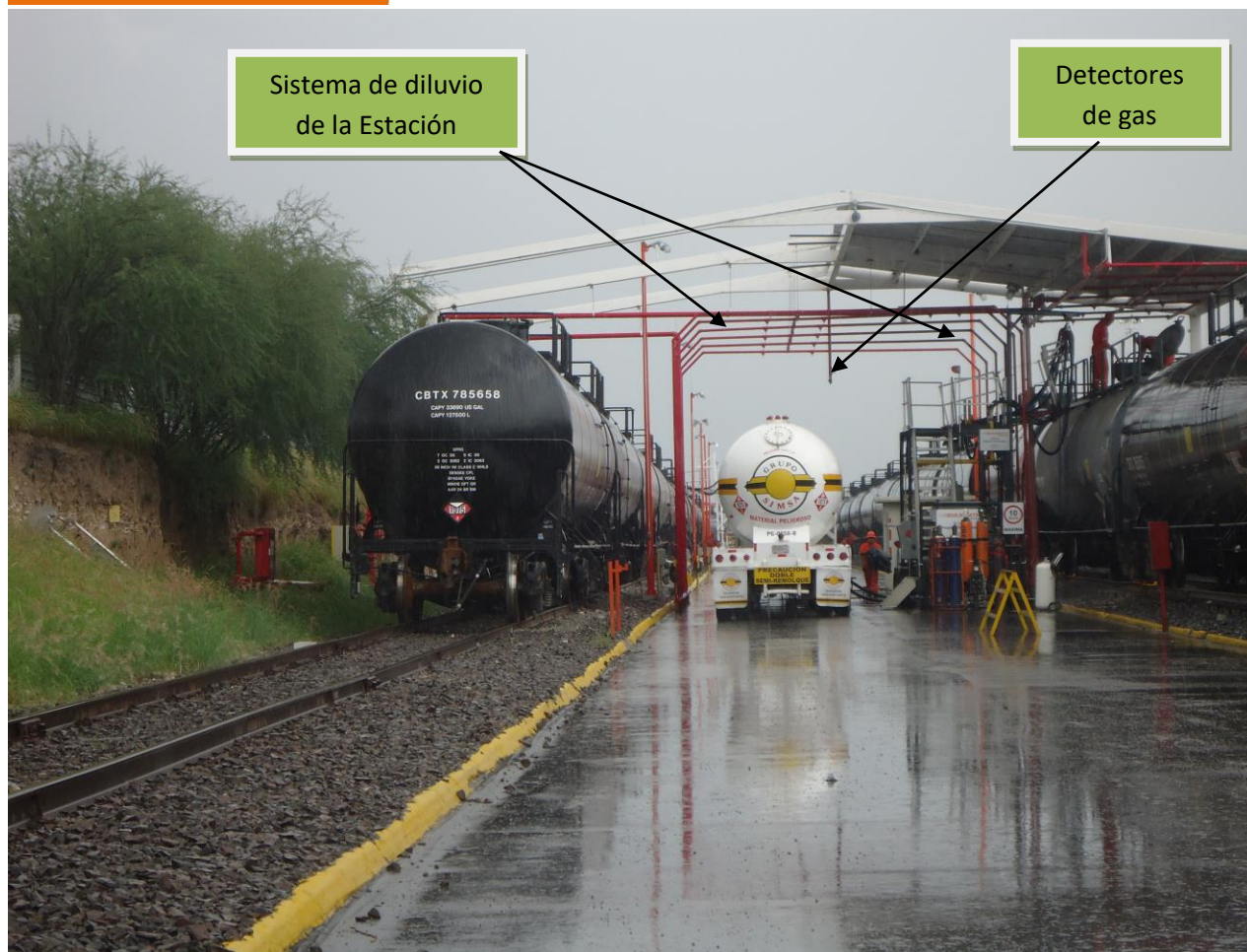
Fig. 5. Estación equipada para trasvase de combustibles.
