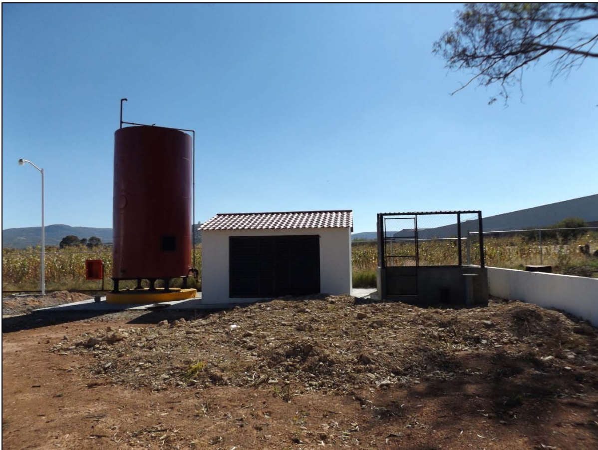
Figura II.13. Tanque de agua del sistema contra incendio y cuarto de bombas.
