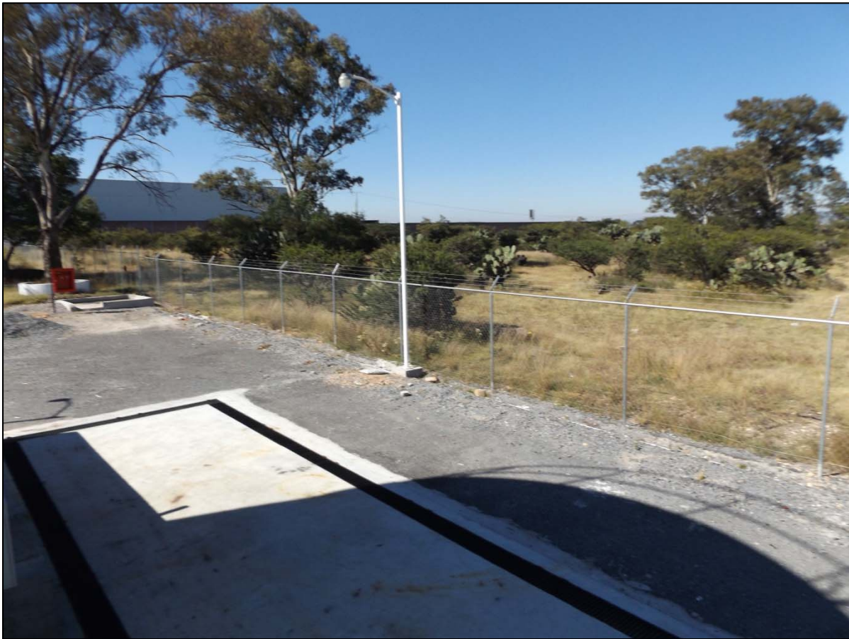
Figura II.17. Rejillas de captación de aguas aceitosas en el área de despacho de combustible.
