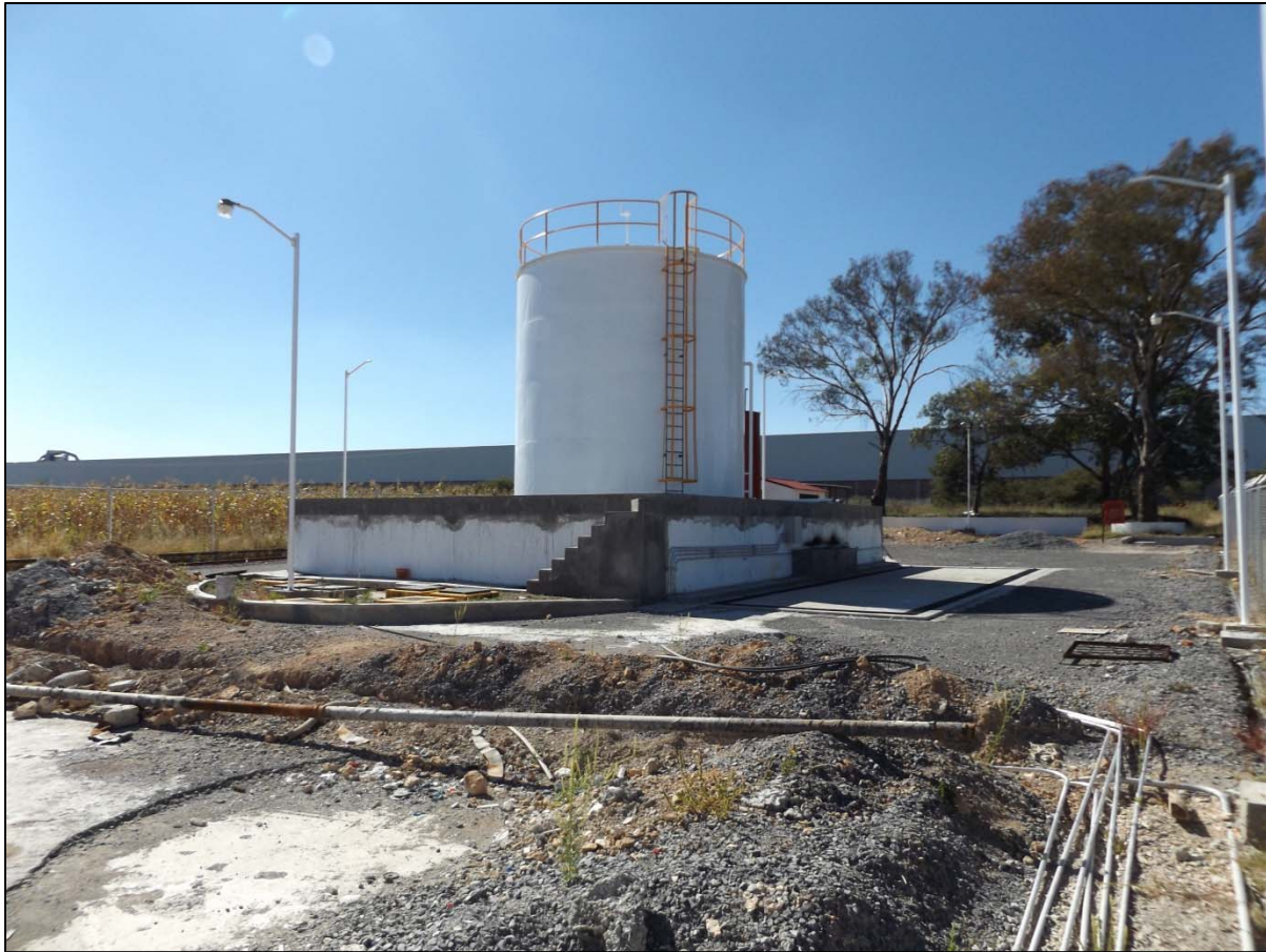
Figura II.14. Tanque de almacenamiento de diésel y dique de contención.
