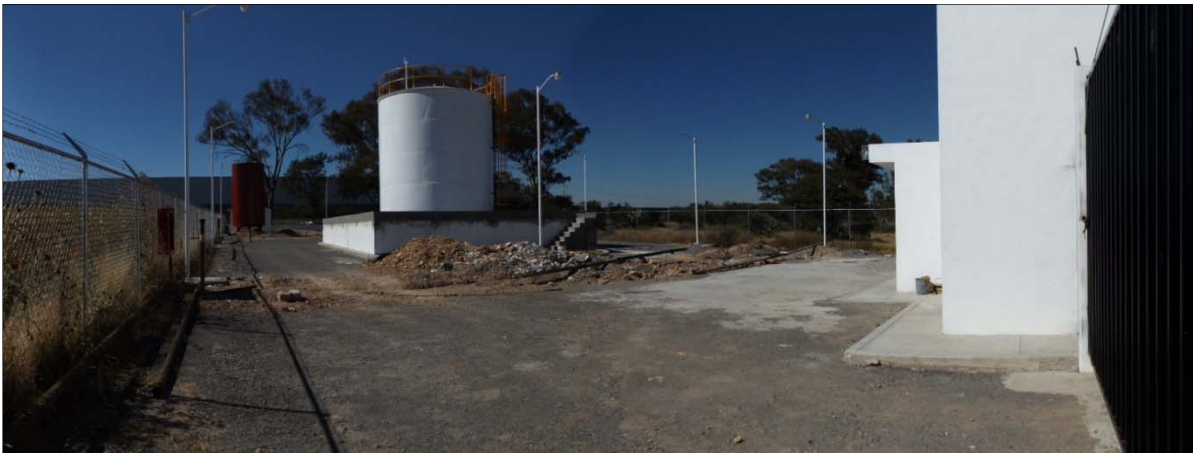
Figura II.5. Instalaciones dentro del predio destinadas al almacenamiento y distribución de Diésel.
