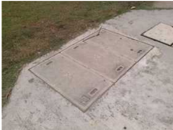
Foto 3. 16° 48' 08,05" – 99° 49' 21,11" Registro de CFE a un costado del predio donde se ubicará la Estación de Regulación.
