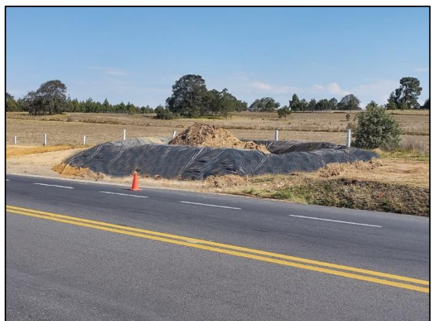
18. El material edáfico afectado con Diésel fue depositado en la celda provisional.
