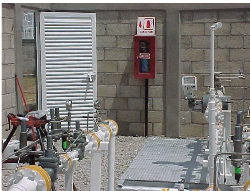
FIGURA 34. EXTINTOR TIPO ABC EN CASETA DE MEDICIÓN Y REGULACIÓN (INTERCONEXIÓN)
