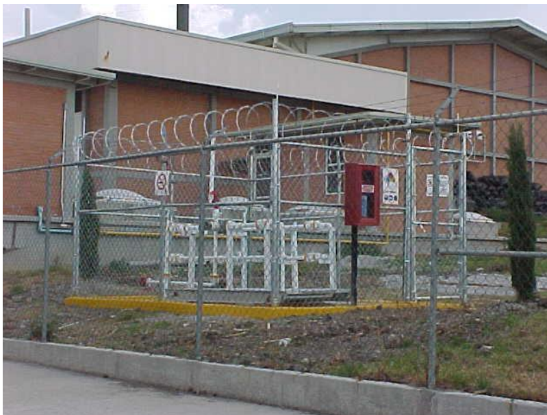
FIGURA 35. EXTINTOR TIPO ABC EN CASETA DE MEDICIÓN Y REGULACIÓN (USUARIO)
