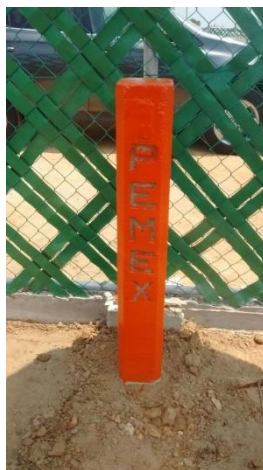
Figura 4. Tipo Poste de toma de potencial.
