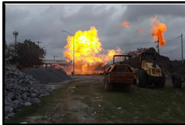
Foto 4. Explosión causada por maquinaria.
