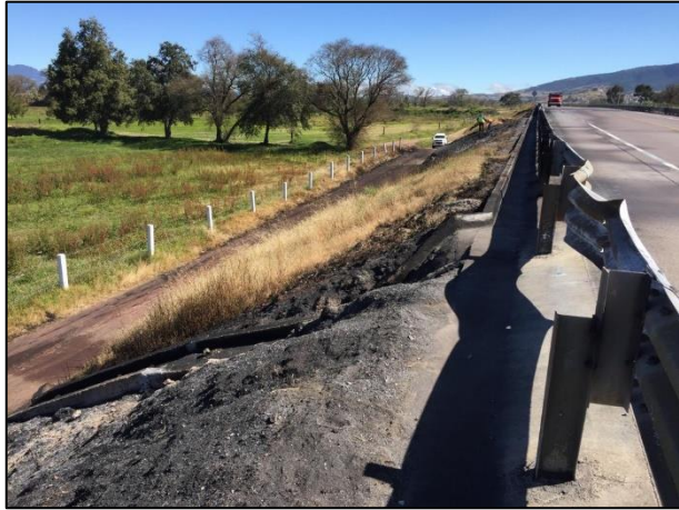
01.- El sitio de derrame se ubica a la altura del Km. 97 de la Autopista México - Tuxpan, municipio de Tulancingo, estado de Hidalgo.
