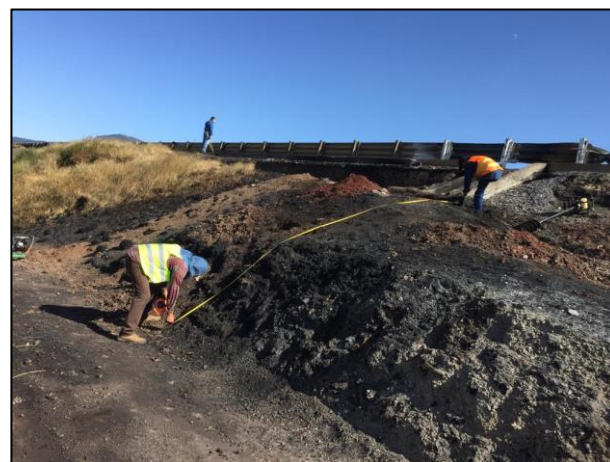
12.- Se tomaron medidas de las manchas causadas por la Gasolina derramada.
