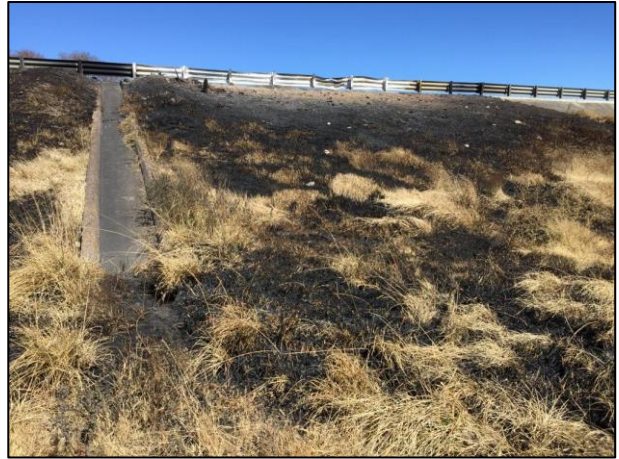
02.- Durante la visita inicial se observó la afectación por el incendio en el sitio suscitado durante el derrame.
