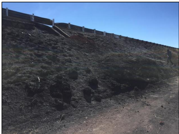
01.- La Zona afectada A generada por el derrame constituye parte y soporte del talud de la Autopista, razón por la cual dicha zona no será sometida a extracción.
