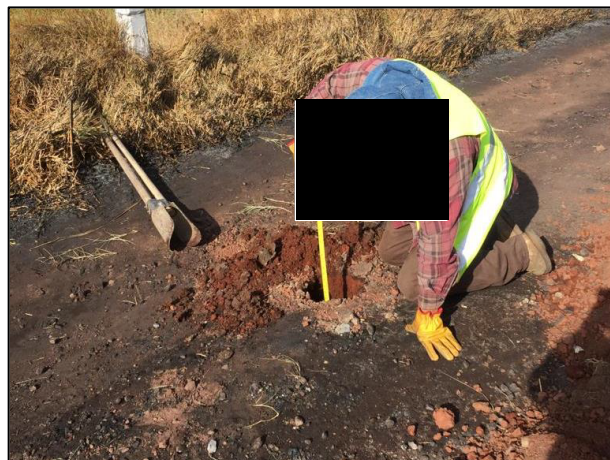
08.- Con apoyo de flexómetro se verificó la infiltración que alcanzó la Gasolina derramada sobre el camino de terracería.
