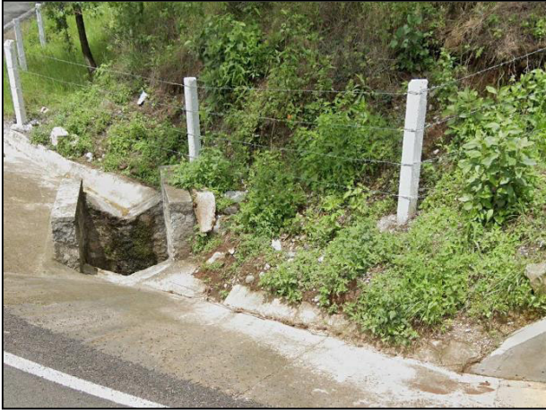
07. El Combustóleo Pesado cruzó la vialidad de concreto a través de un ducto subterráneo.
