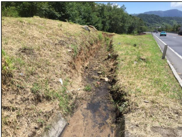
03. El Combustóleo Pesado desembocó en suelo natural posterior al desplazamiento sobre la canaleta de concreto.
