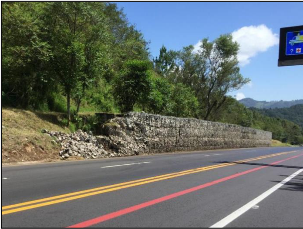
01. El sitio en estudio se ubica en el Km. 138 + 400 de la Carretera Tulancingo – Tuxpan, municipio de Huauchinango, estado de Puebla. Muro de contención impacto por la unidad transportadora.
