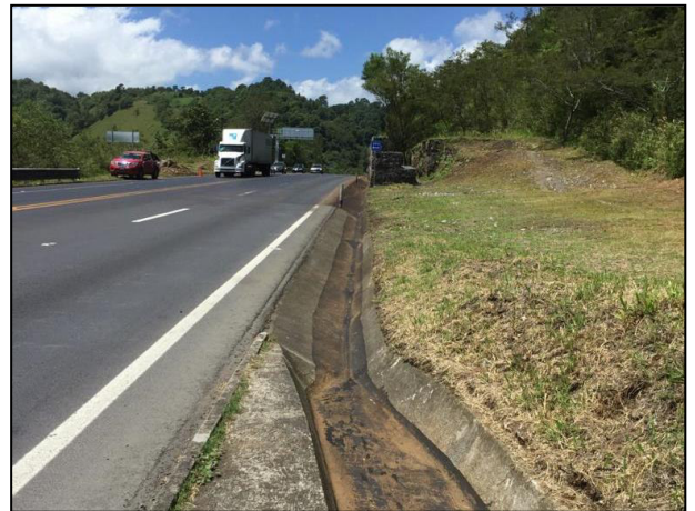
02. El hidrocarburo se desplazó a través de una canaleta de concreto para posteriormente desembocar en suelo natural.
