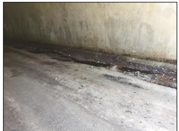
06. El hidrocarburo continuó su trayecto sobre canaleta de concreto presente en el paso subterráneo (vialidad de concreto).
