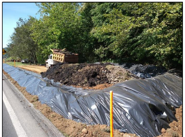
18. Depósito en celda provisional del material edáfico afectado por el derrame de Combustóleo Pesado.
