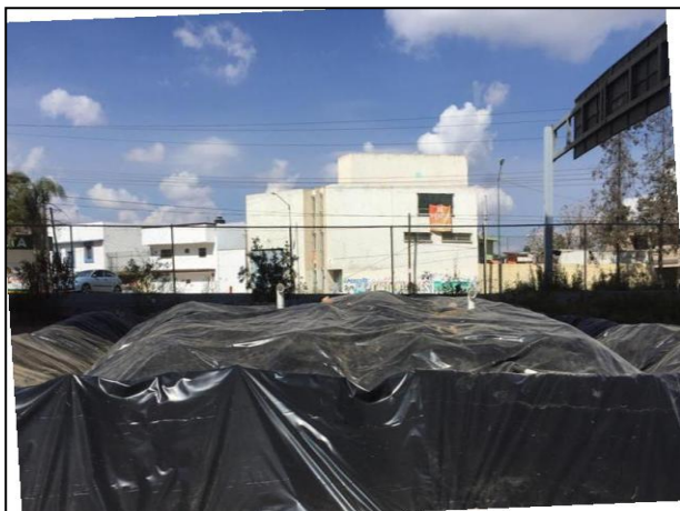
28. Celda Provisional con filtros de carbón activado.
