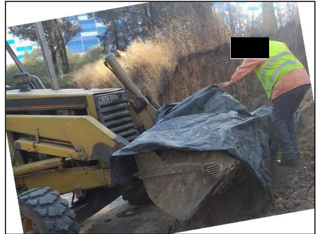
20. Extracción del material edáfico afectado con Gasolina en el talud de la carretera.
