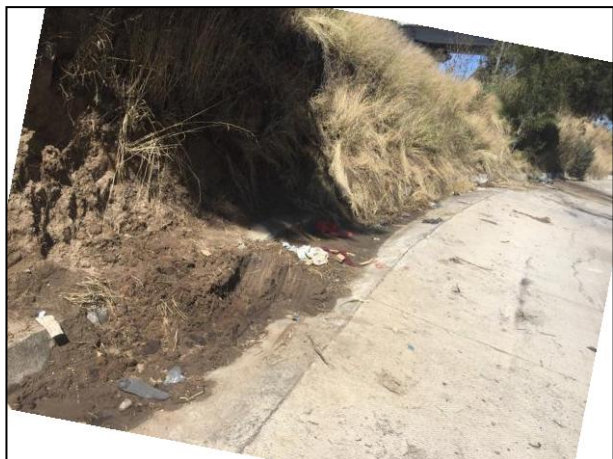
3. Afectación de material edáfico azolvado en la canaleta de concreto ubicada a un lado de la carretera y talud de suelo natural.
