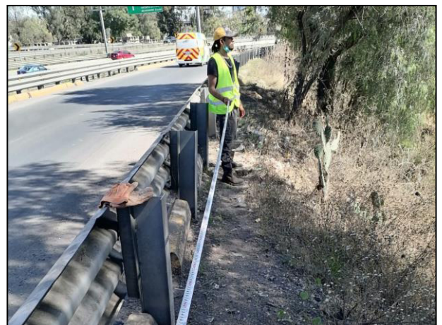
06. Con apoyo de cinta métrica se realizaron las mediciones de las Áreas Afectadas.
