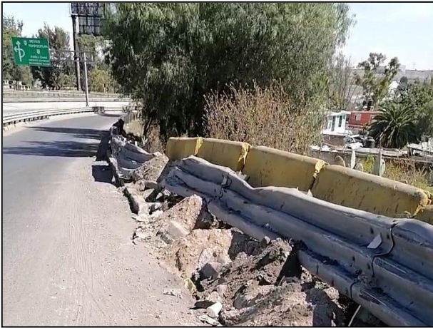
01. El sitio del derrame se ubica en el derecho de vía a la altura del Km. 01 de la Carretera Tula – Jorobas, municipio de Huehuetoca, Estado de México.
