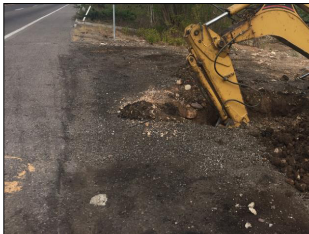
4. El lugar de afectación pertenece al derecho de vía de la carretera.
