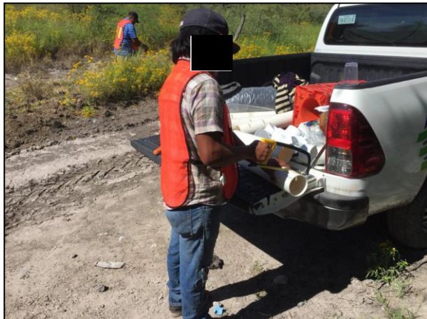
03. Preparación de los filtros de carbón activado.
