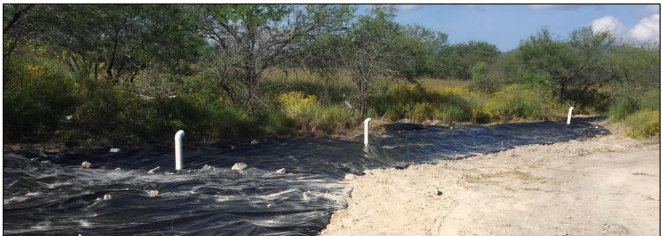
11. Vista de las Zonas Afectadas sometidas a Labores de Emergencia.
