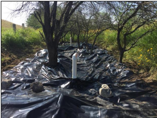
09. Se realizó la colocación de filtros de carbón activado para captación de vapores
