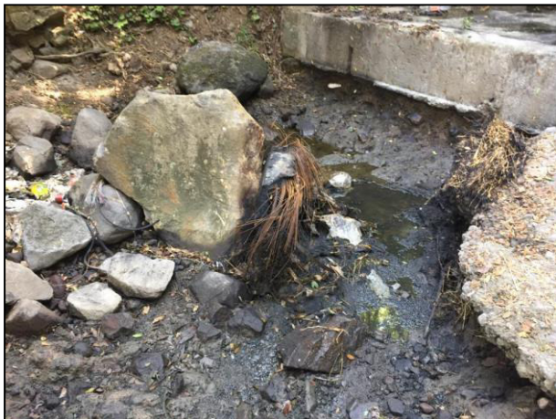
09. Afectación superficial por el derrame de Diésel posterior al canal de concreto de captación pluvial.
