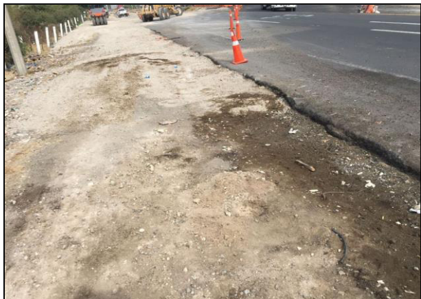
7. Mancha evidente de la afectación en el sitio.
