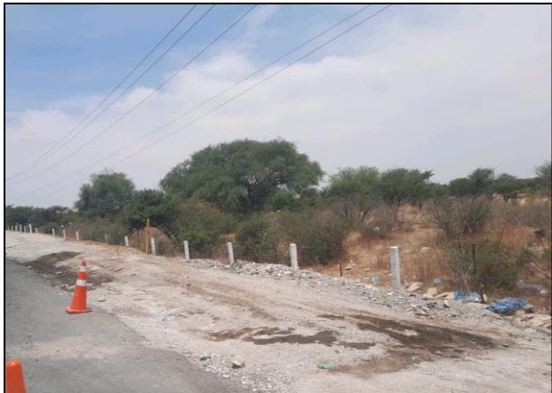
1. El sitio de derrame se ubica en el Km. 117 + 500 de la Carretera (2877) Zapotlanejo – El Desperdicio (Directo), municipio de San Juan de los Lagos, Jalisco.
