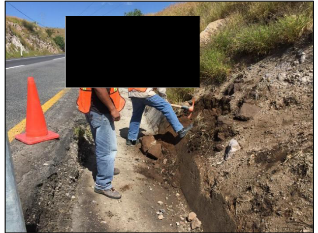
14. Con apoyo de recurso humano equipado de herramienta manual, se procedió a extraer el material edáfico afectado encontrado en el talud de la carretera.
