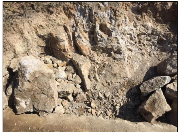
28. En el lugar de la Zona de Extracción, se observa la presencia de material rocoso.
