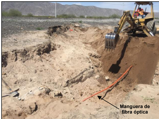
15. Durante las actividades de extracción se encontró la presencia de una manguera subterránea de fibra óptica.
