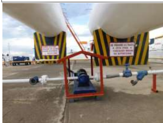
Bombas de trasiego GLP B-III
