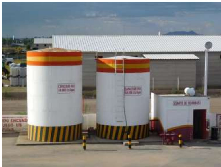
Figura IV.6 Cisternas para el sistema contra incendios.
