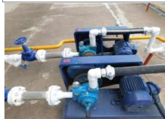
Bombas de trasiego GLP B-IV y B-V
