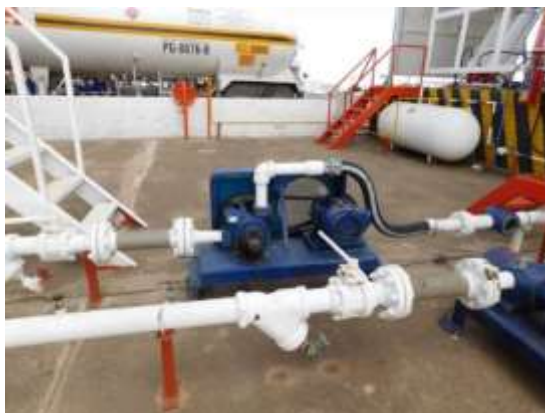
Bombas de trasiego GLP B-I
