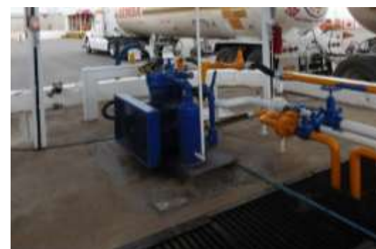
Bombas de trasiego GLP C-II
