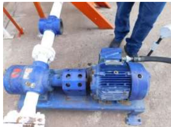
Bombas de trasiego GLP B-II
