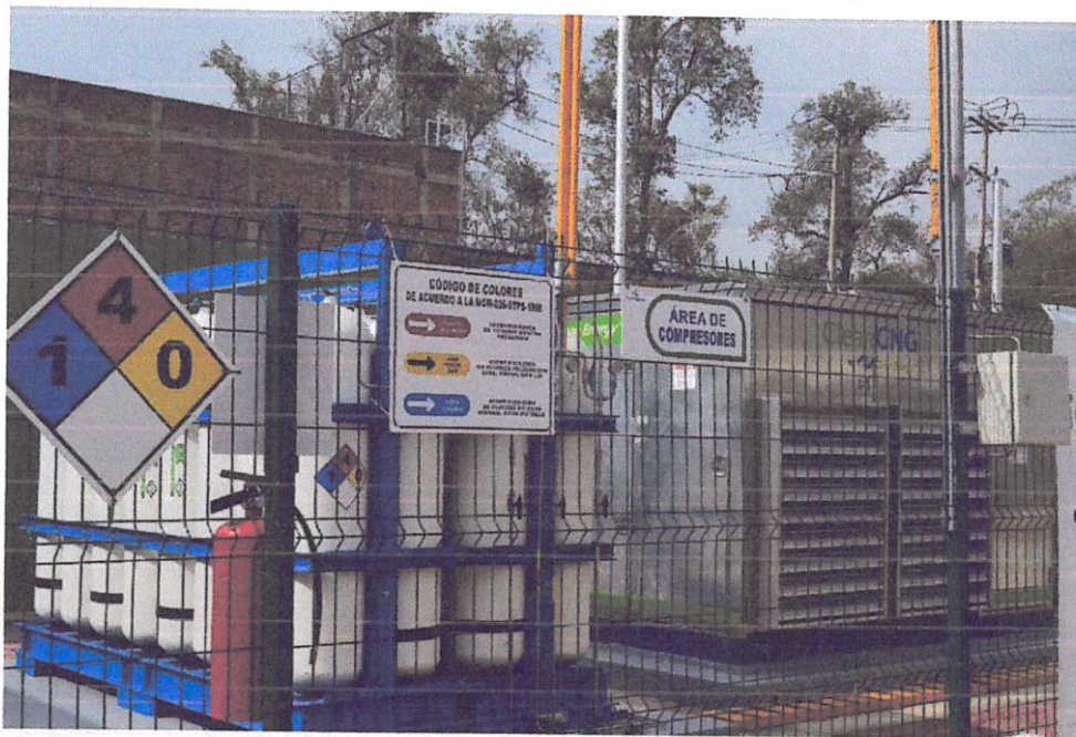
Figura 1.- Recipientes y/o tanques cilíndricos.
