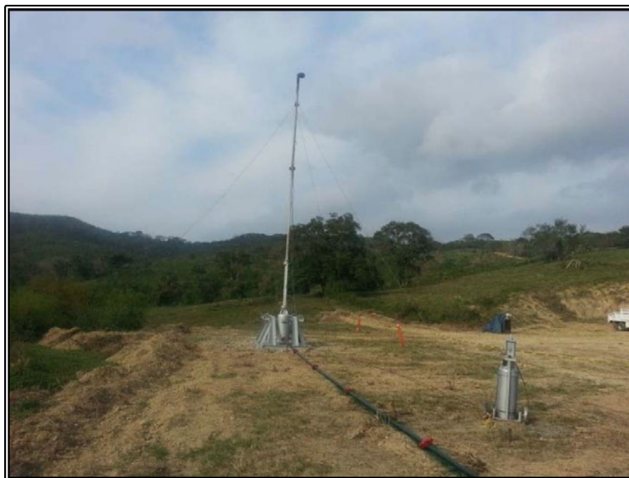
Fotografía III-11.- Fotografía de referencia de quemador vertical instalado.
