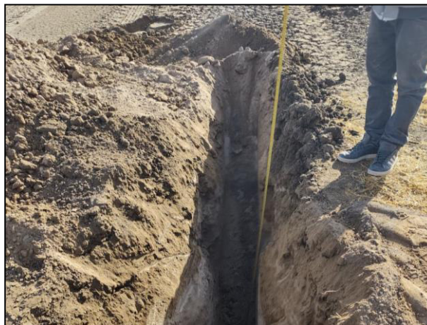
06. Con ayuda de flexómetro se corroboraron las infiltraciones en el suelo afectado por Diésel Automotriz.
