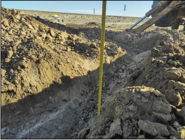
07. Determinación de la infiltración del hidrocarburo en suelo natural.
