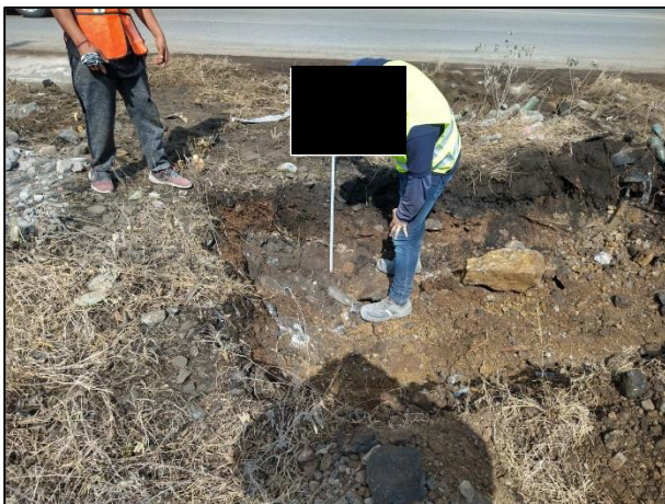
05 - Con apoyo de flexómetro se verificó la profundidad de infiltración de la sustancia en la Zona afectada.
