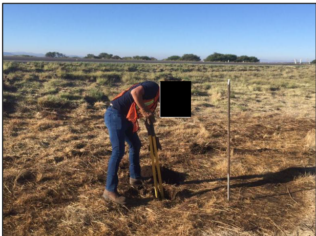
05 - Con apoyo de personal de campo se realizaron sondeos en el sitio en estudio con el fin de conocer la infiltración de Diésel en el suelo natural.
