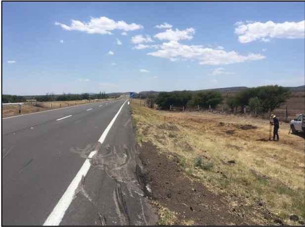
01 - El sitio de derrame se ubica a la altura del Km. 069 + 000 de la Autopista Torreón – Durango (tramo Durango – Yerbanis), municipio de Guadalupe Victoria, estado de Durango.
