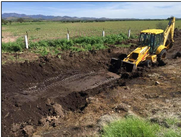
15 - Zona afectada sometida a Labores de Extracción.
