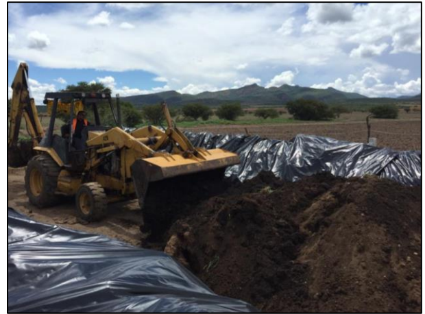
14 - Depósito del material edáfico afectado por el derrame de Diésel.
