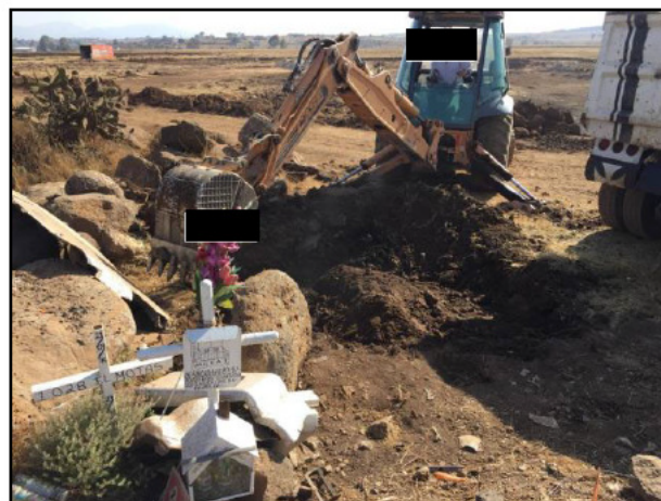
16. Extracción del material edáfico afectado con Diésel.
