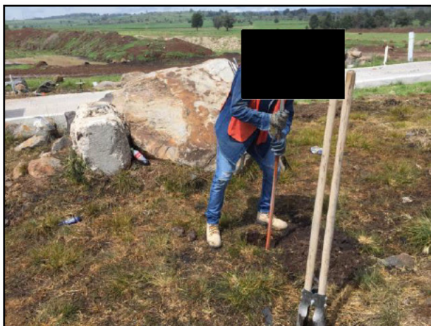
5. Con apoyo de una pocera se realizaron sondeos en el suelo natural afectado.
