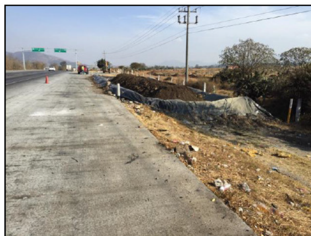
18. Material edáfico afectado por el Diésel derramado, colocado en la Celda Provisional.
