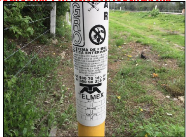
10. Se observó postería de TELMEX que indica la presencia de fibra óptica.
