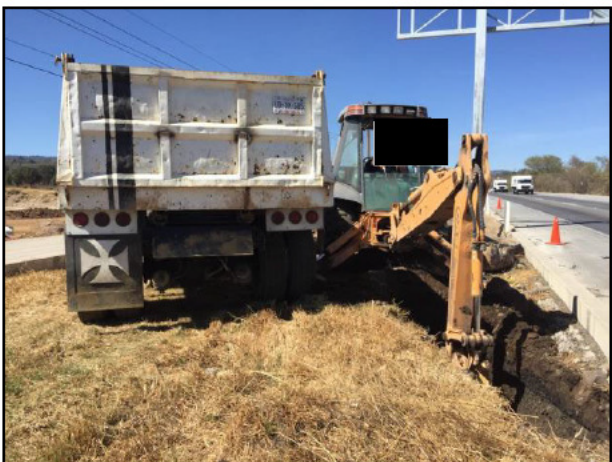
11. Extracción del material edáfico afectado en el camellón (jardinería) encontrado contiguo a la carretera.
