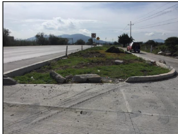
2. El derrame afectó el camellón (espacio jardinero) encontrado a un lado de la carretera.
