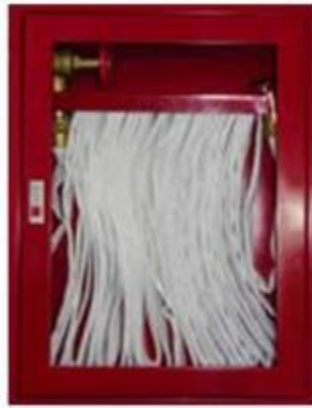
Ilustración 7. Sistema de gabinetes con manguera
