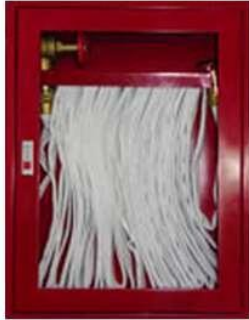
Sobrepuesto a muro
