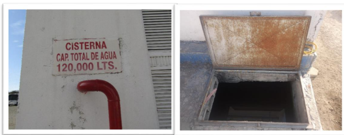
Figura IV.4: Cisterna de 120,000 L.
