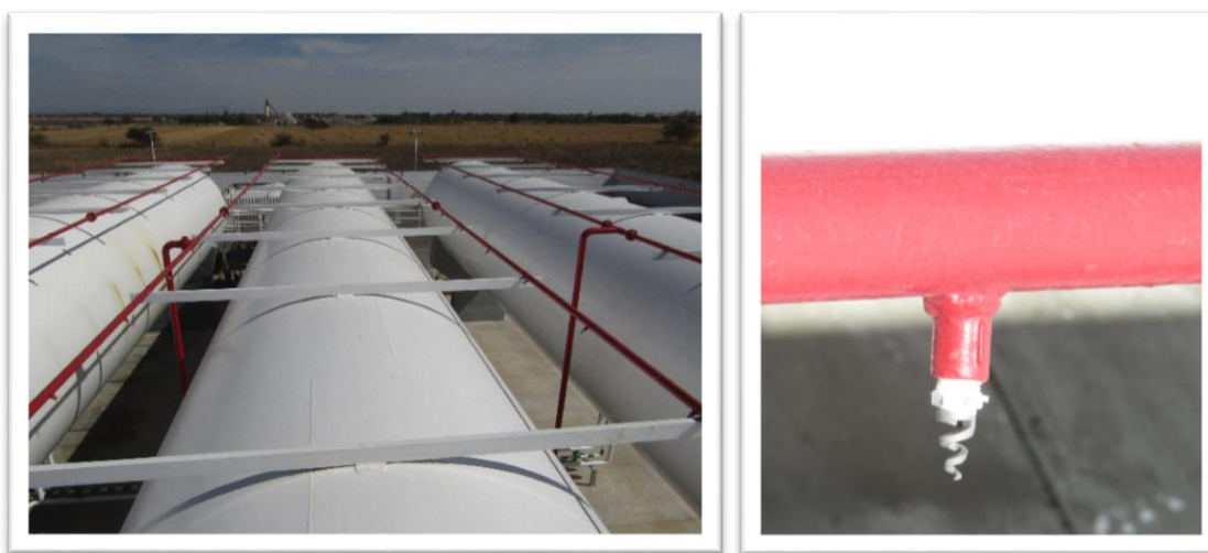
Figura IV.2. Sistema de enfriamiento por aspersión de tanques de almacenamiento.
