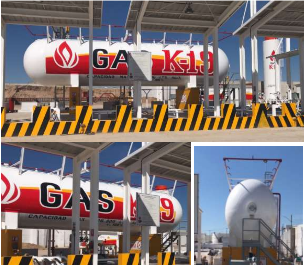
FOTOGRAFÍA 6. RECIPIENTE DE ALMACENAMIENTO TEMPORAL DE GAS L.P.
