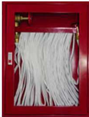
Sobrepuesto a muro
