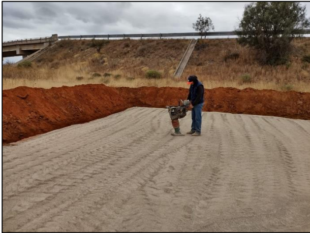
07. Con apoyo de vibro compactador manual se realizó la compactación de la capa de arcilla.
