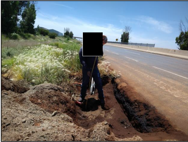
07. Con ayuda de flexómetro se corroboraron las infiltraciones en el suelo afectado con Diésel.
