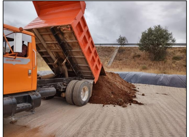
14. Depósito del material edáfico afectado por el derrame de Diésel en celda provisional.
