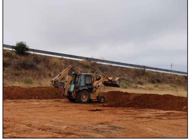
02. Con apoyo de retroexcavadora se construyeron los bordos perimetrales de la celda provisional.
