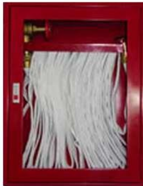
Sobrepuesto a muro
