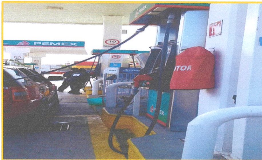
Zona de despacho para combustibles al público en general (dispensarios y mangueras) de la ES No. 1059.
