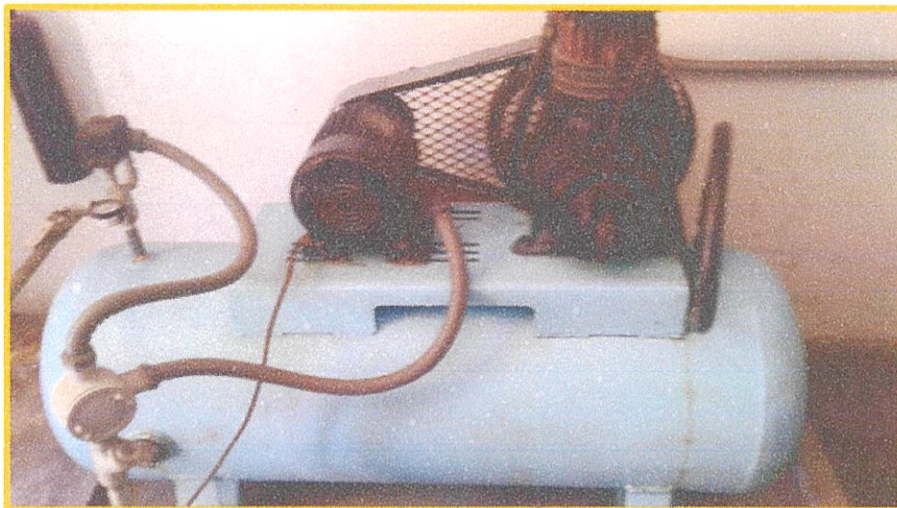
Compresor utilizado en la Estación de Servicio No. 1059.
