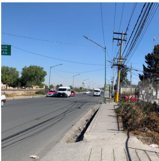
Foto 5- Infraestructura eléctrica sobre Av. Recursos Hidráulicos.
