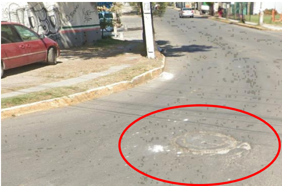
Foto 11- Pozo de visita sobre calle Quintana Roo.
