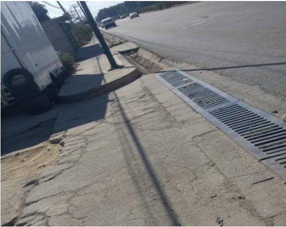
Foto 9- Infraestructura de drenaje pluvial sobre Av. Recursos Hidráulicos esquina con calle Quintana Roo.
