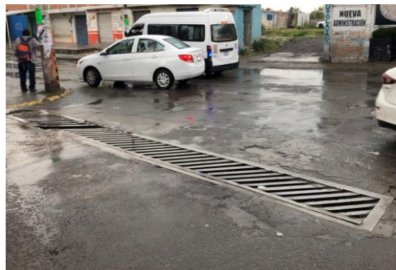
Foto 12- Alcantarillado pluvial sobre la Av. Las Ánimas.
