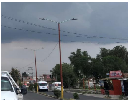
Foto 8- Alumbrado público dentro del polígono de actuación del proyecto.
