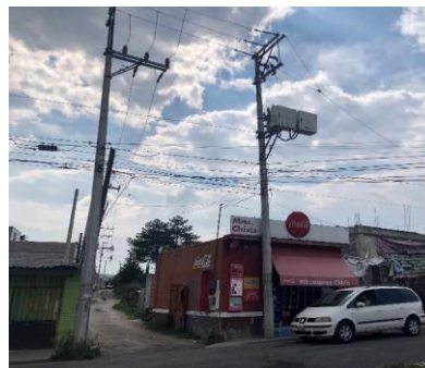
Foto 10- Infraestructura eléctrica sobre la Av. Las Ánimas.
