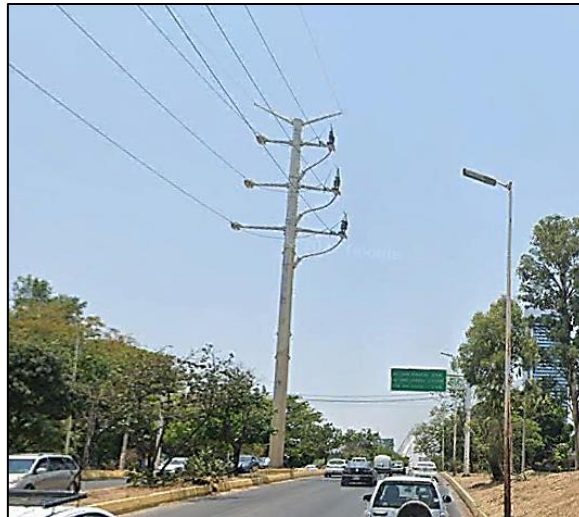
Imagen 10. Línea de alta tensión sobre vía Carretera Guadalajara-Tepic.
