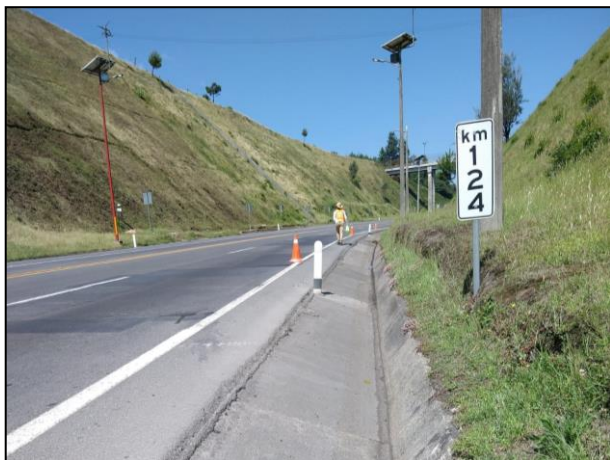
02. El sitio en estudio se encuentra en el Km. 124 + 500 de la Autopista No. 132-D Tulancingo - Huauchinango, municipio de Acaxochitlán, estado de Hidalgo.
