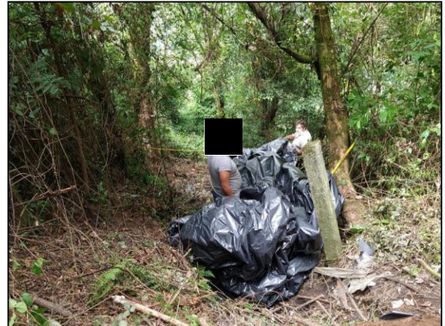
02. El área afectada fue cubierta en su totalidad con película de polietileno de alta densidad para evitar la transferencia suelo – atmósfera del hidrocarburo derramado.
