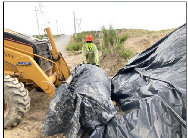
22. Durante el manejo del material contaminado este permaneció cubierto con membrana de polietileno de alta densidad.
