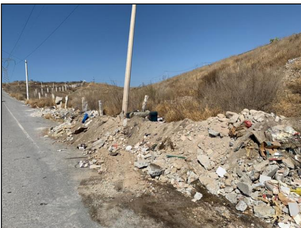
05. Montículos de basura y escombros contaminados con Gasolina presentes a orillas de la vialidad de carpeta asfáltica.
