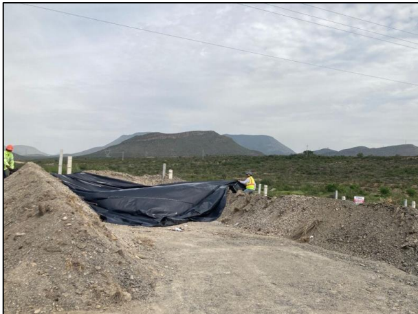
03. Con apoyo de recurso humano se tendió una membrana de polietileno de alta densidad sobre la base de la celda temporal.
