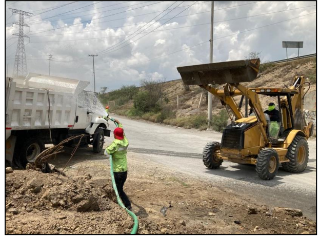
32. Humectación del material contaminado a fin de evitar su dispersión y emisión de gases a la atmosfera.
