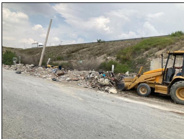
05. Recolección del material contaminado (basura y escombros) por la Gasolina.
