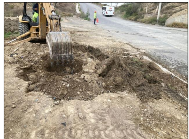
28. Con apoyo de maquinaria pesada y recurso humano se realizó la humectación y extracción del material edáfico contaminado. Extracción en la Fosa de Excavación “B”.
