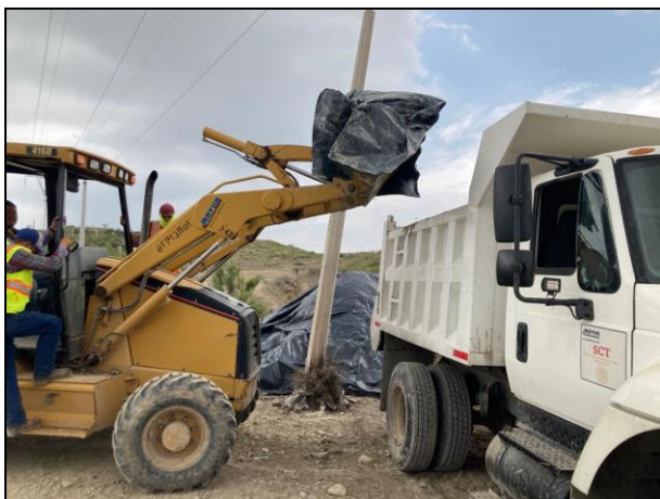
23. Depósito del material contaminado en camión de volteo para su posterior depósito en celda provisional.
