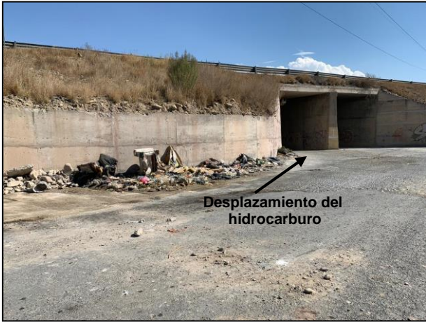
13. Posteriormente el hidrocarburo continuó su desplazamiento pasando a través de un paso a desnivel (Entrada)
