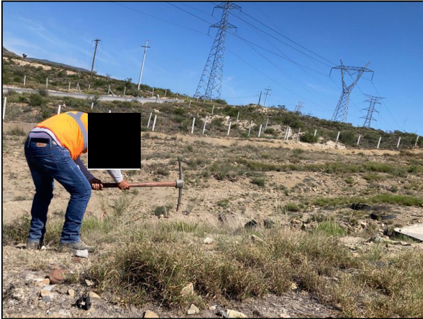
01. En el sitio se realizó la construcción de una barrera de contención (zanja) alrededor del Área Afectada a fin de mitigar el desplazamiento del hidrocarburo.
