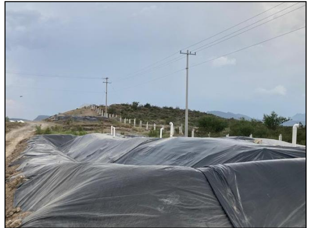
44. Celda provisional con filtros de carbón activado,
