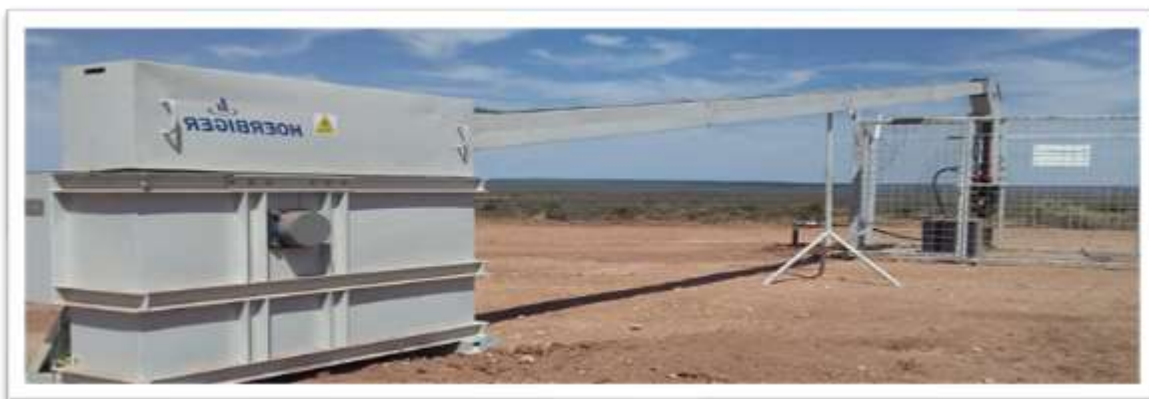
Figura V.1-20. Imagen representativa de boca de pozo tipo cubeta
