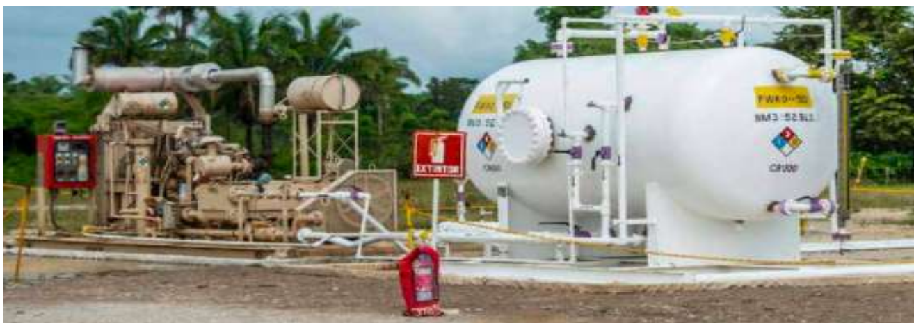
Figura V.1-28. Imagen representativa de boca de pozo Jet Pump
