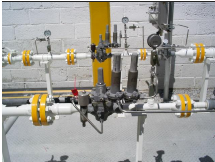
Figura X.94. Fotografía ilustrativa reguladores de presión Fuente: propiedad de Gas Natural Potosino
