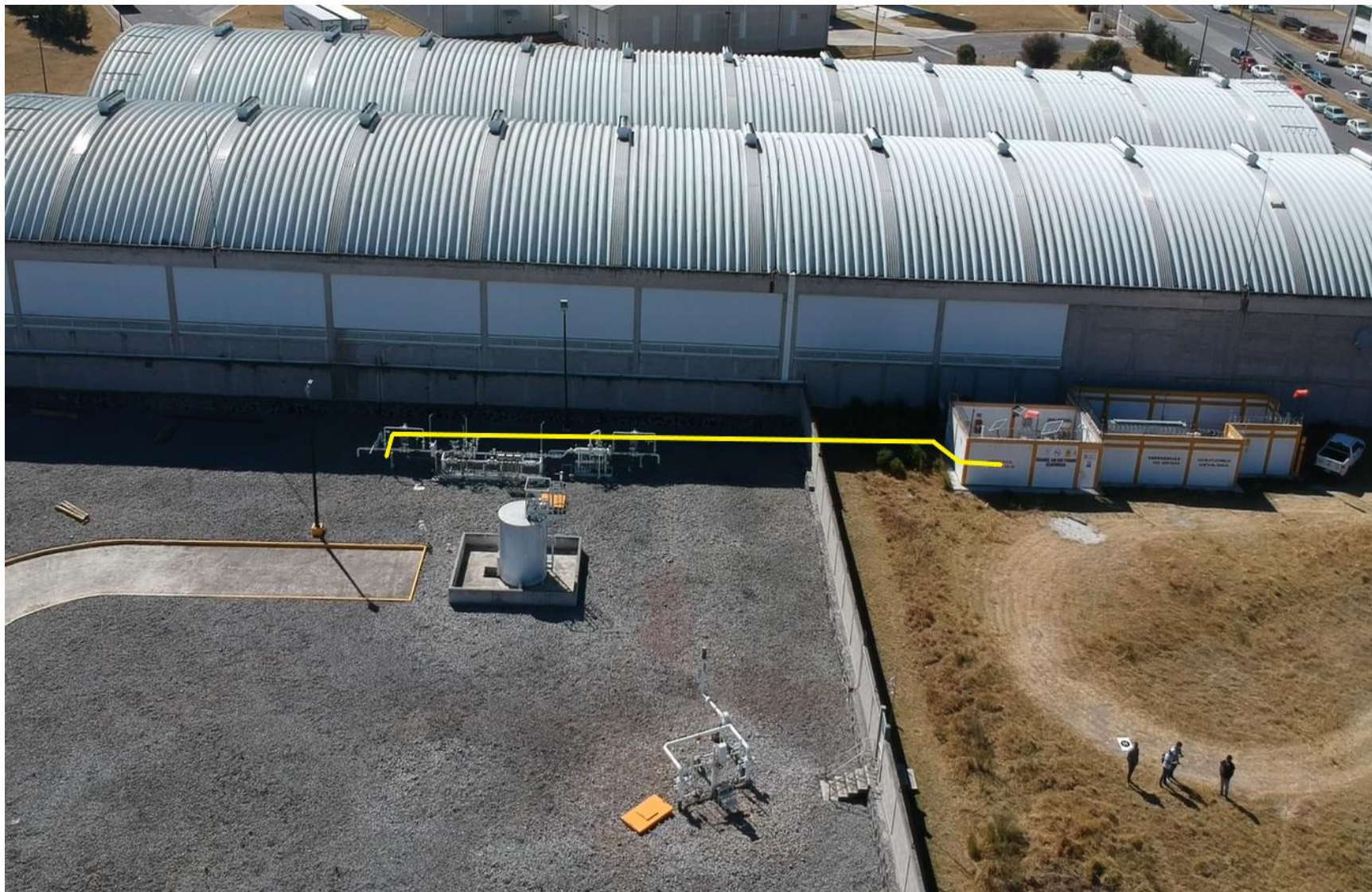
Figura X.02. Fotografía de la Interconexión y del ducto de Interconexión
