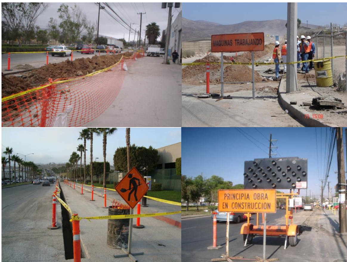
Figura X.102. Fotografía ilustrativa de Señalizaciones Fuente: propiedad de Gas Natural Potosino
