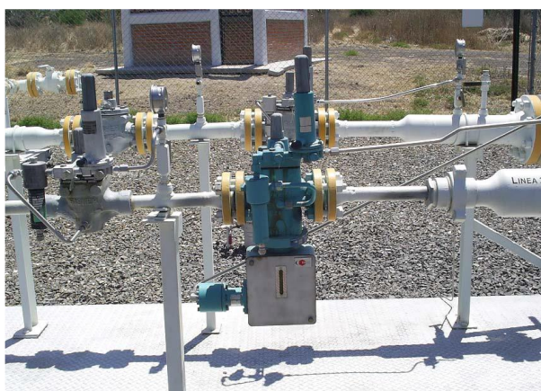
Figura X.96. Fotografía ilustrativa Slam-Shut Fuente: propiedad de Gas Natural Potosino
