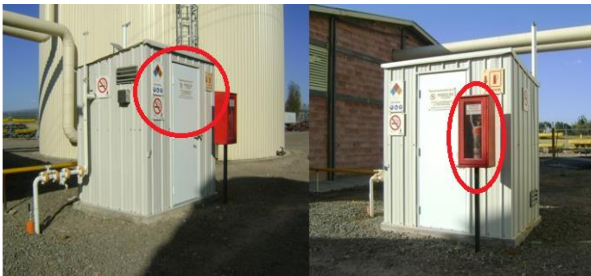
Figura X.76. Ejemplo de colocación de extintor y señalamientos de seguridad
