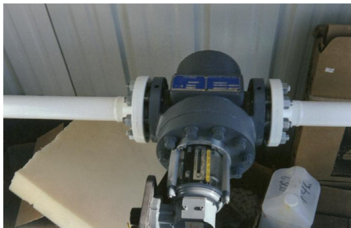
Figura X.95. Fotografía ilustrativa Medidor de flujo Fuente: propiedad de Gas Natural Potosino
