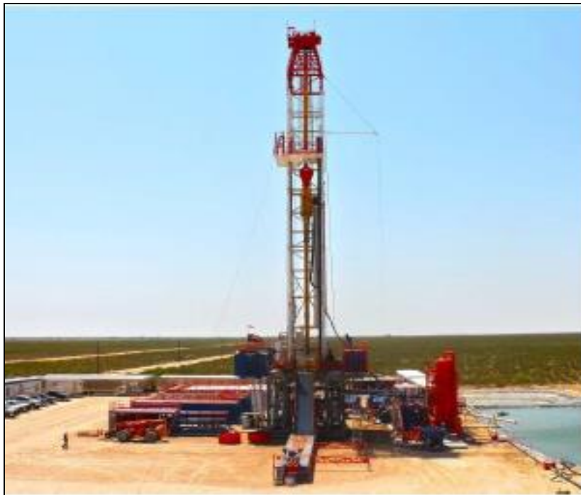
Figura 18. Ejemplo de un Equipo Parker 212-1,500 hp Land Drilling Rig.
