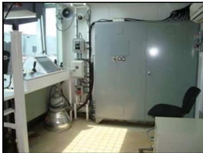
Figura 62. Ejemplo de un cuarto de control remoto de los equipos de perforación y de reparación mayor.
