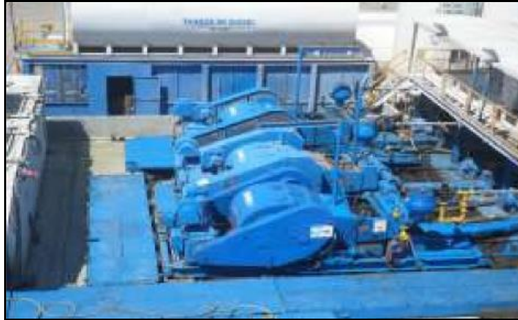
Figura 23. Área de bombas.
