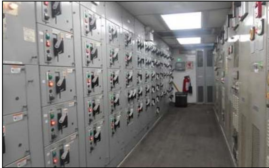
Figura 24. Cuarto de control eléctrico.
