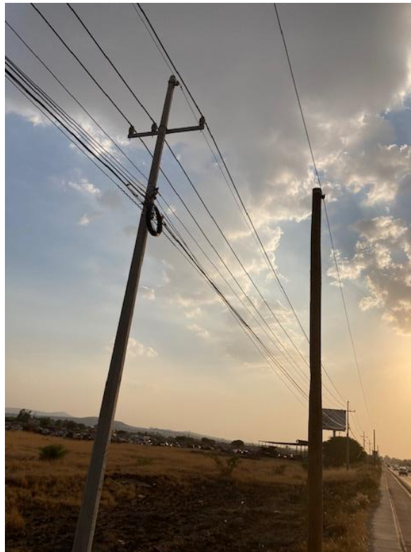
Ilustración 11.- Líneas eléctrica y telefónica aéreas, al norte del predio, sobre la Carr. Querétaro-Tequisquiapan.
