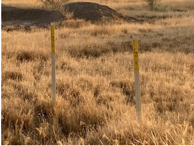
Ilustración 12.- Señalamiento de línea de fibra óptica subterránea
