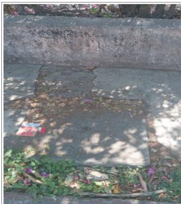
Servicio de drenaje sobre calle principal al predio
