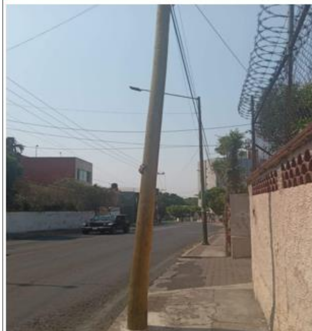
Servicio de alumbrado y telecomunicaciones
