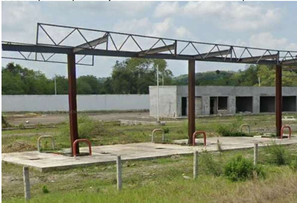
Fotografía No. 5. La estructura de los dispensarios se encuentra oxidada por lo que dentro de las actividades de conclusión de obra se contempla el retiro de toda la estructura para colocar nuevamente y finalizar para operación y mantenimiento.
