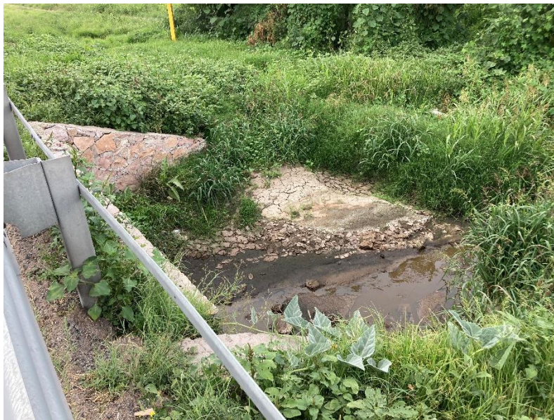
Ilustración 22.- Canalización de aguas pluviales al suroeste del predio, sobre carr. Qro.-SLP
