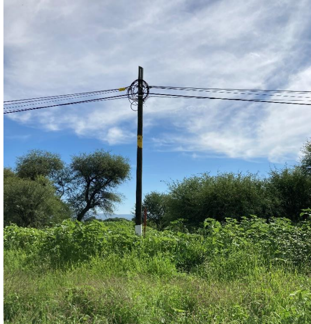
Ilustración 21.- Línea telefónica aérea, al suroeste del predio, sobre carr. Qro.-SLP
