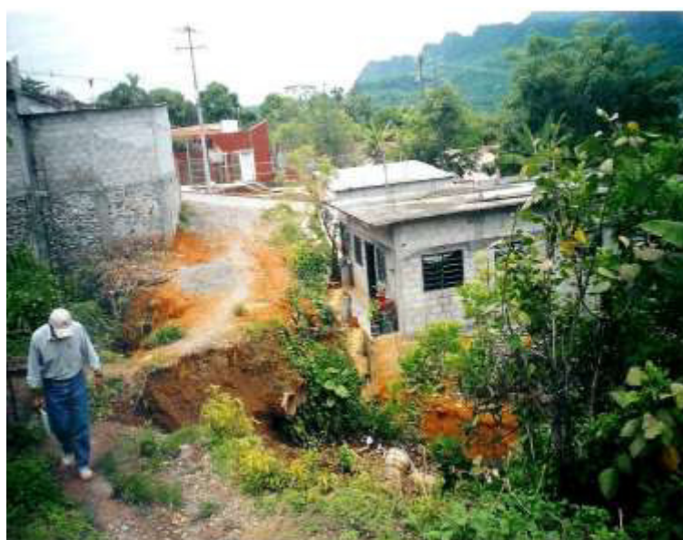
Figura III. 23.- Deslizamiento que afecta la calle, tiene una longitud de 5 m y la roca expuesta son lutitas- limonitas, la dirección de sus echados son similares al a dirección del deslizamiento (NW).
