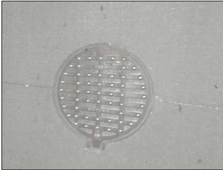
Foto 15.- Línea de alcantarillado.
