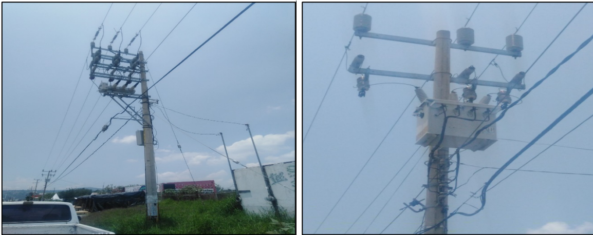
Foto 12.- Línea de media tensión y transformador ubicados sobre Av. Francisco Zarco.
