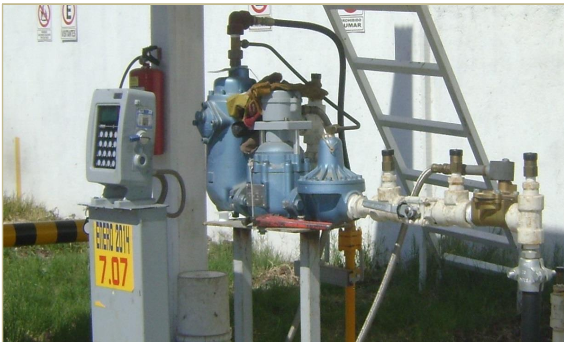
Figura III.1.c)-1. Dispensario doble para el Gas L.P.
