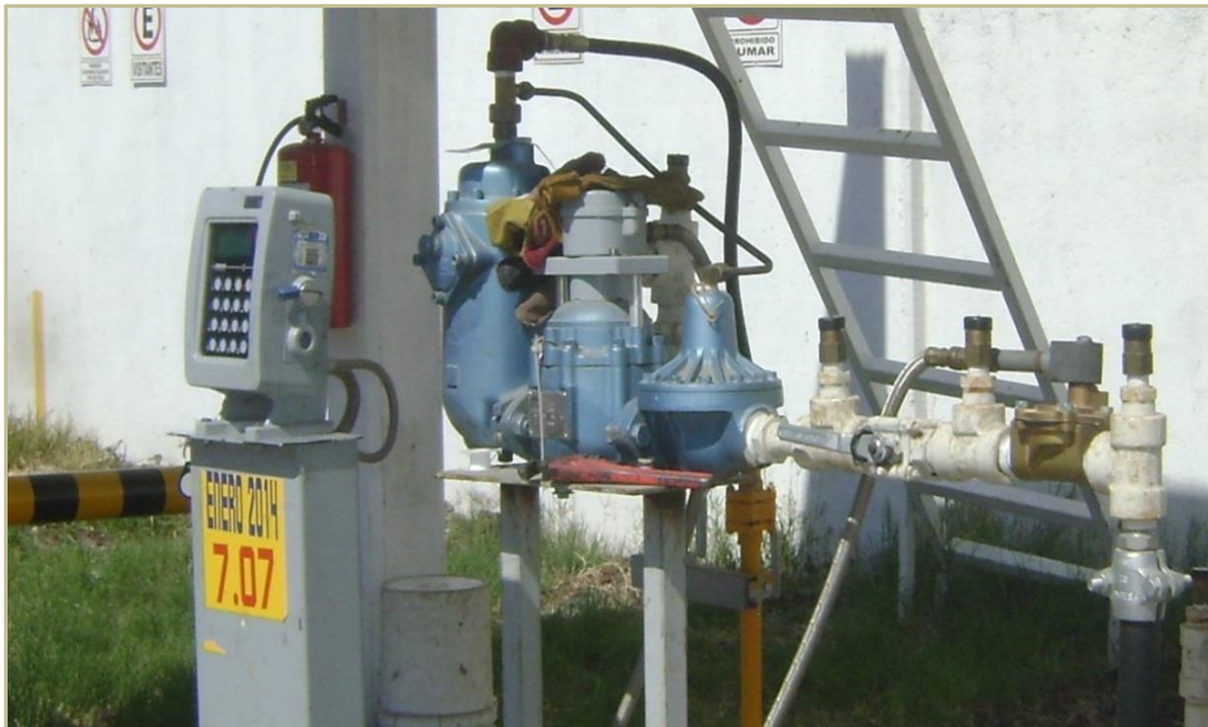
Figura III.1.c)-1. Dispensario doble para el Gas L.P.
